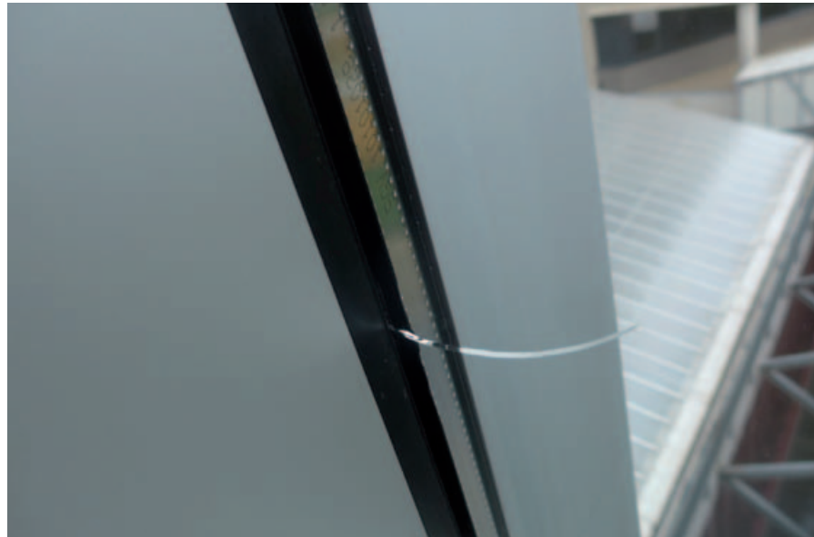
▲ Randschade lijkt de oorzaak. Maar was dat al bij de productie of is dit tijdens het transport gebeurd?
